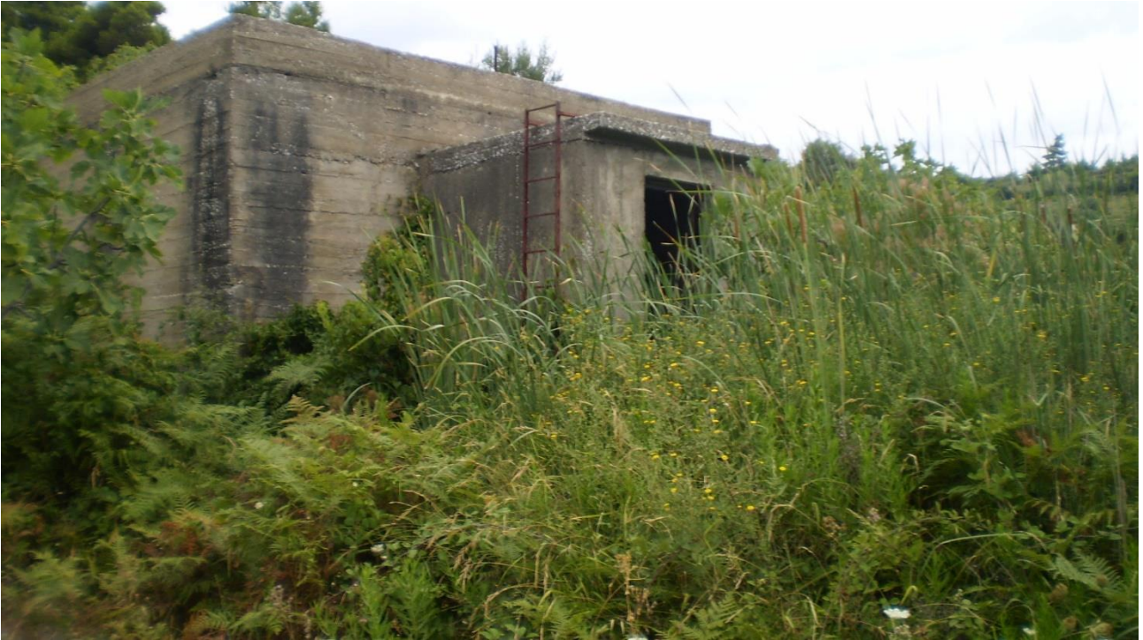
Εικόνα 45 Υφιστάμενη Δεξαμενή – Πύργος
