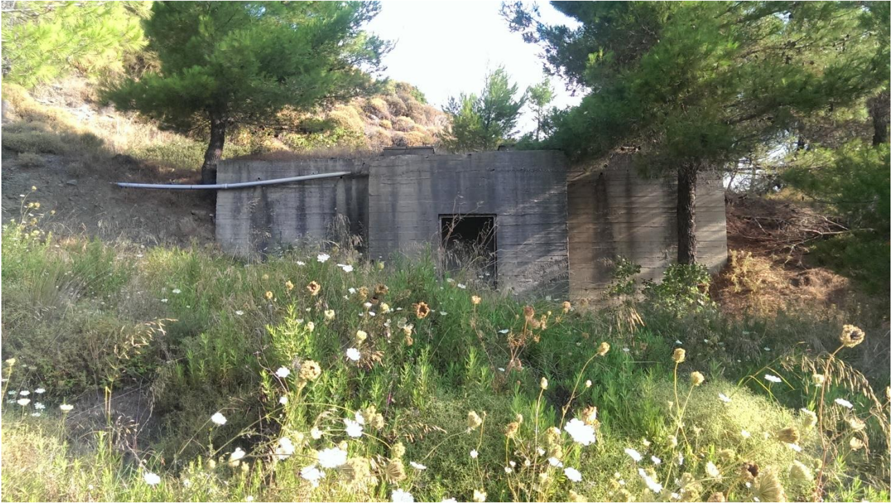
Εικόνα 23 Υφιστάμενη Δεξαμενή – Ανδρωνιανοί
