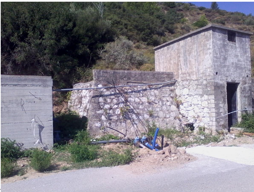
Εικόνα 44 Υφιστάμενη Δεξαμενή – Ποταμιά
